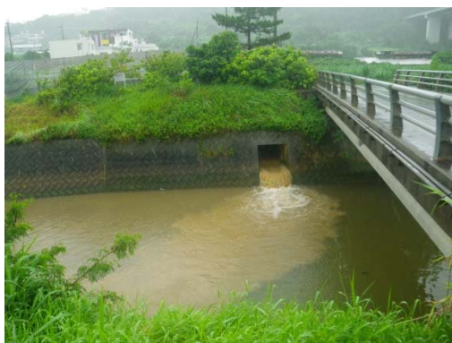
地点 水路から本川への濁水流出
