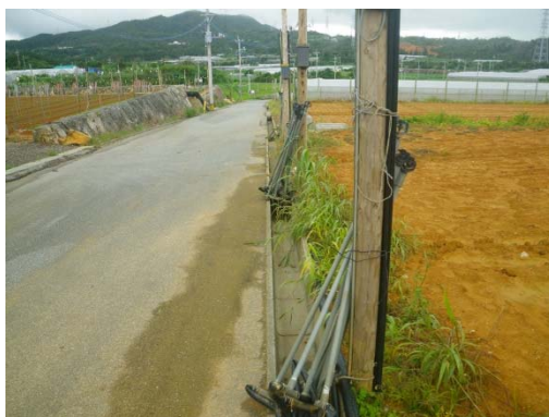
地点 水路への流出無し
