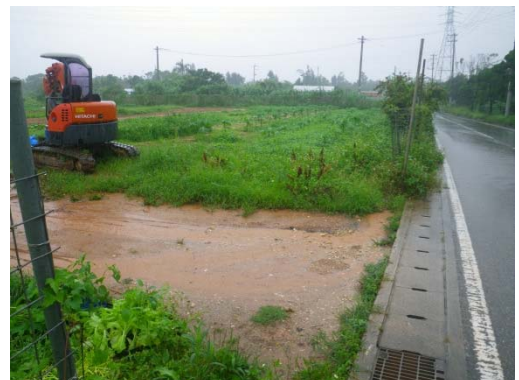
地点 前回確認流出懸念箇所(今回流出無)
