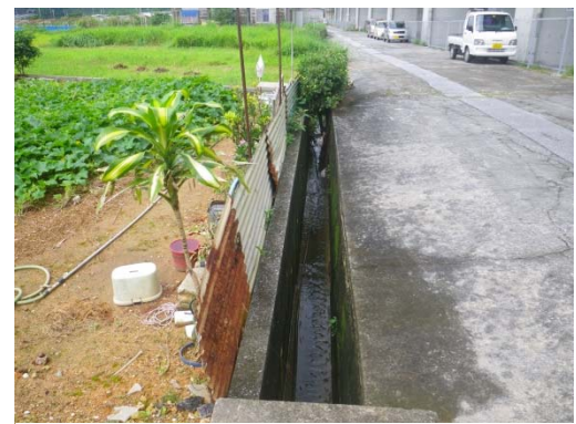
地点 水路への流出無し
