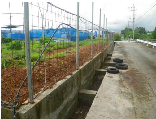
地点 水路への流出無し
