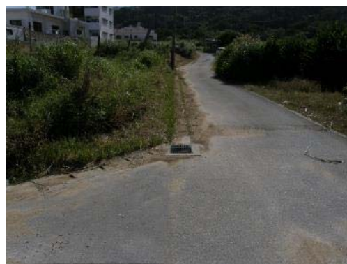
地点 排水路上流側の赤土流出痕(第1回目地点 )
