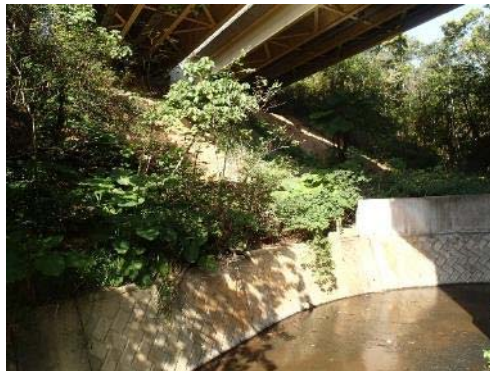
地点 高架下の崩落痕(1回目地点 )
