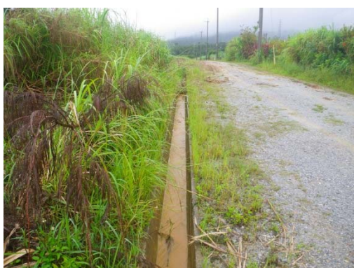
地点 排水路内濁水
