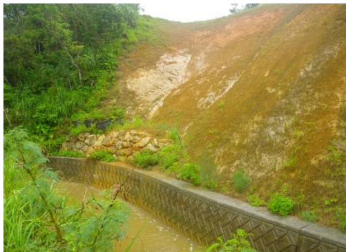
地点 崩落斜面跡
