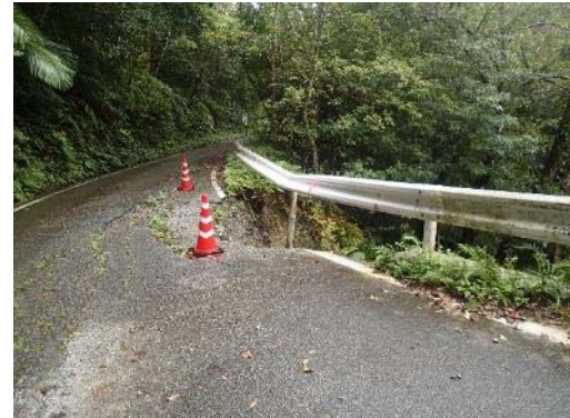
地点 土砂崩れの状況
