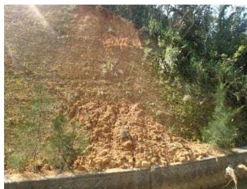
地点 赤土流出箇所(1回目地点 )
