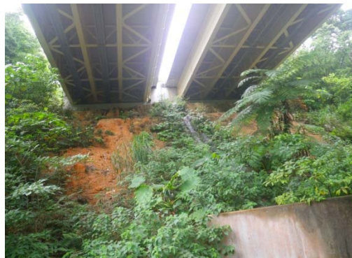
地点 高架下の崩落痕
