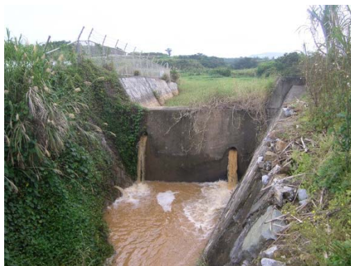
儀間川河口 沈砂池からの濁水流出 (平成 25 年度)
