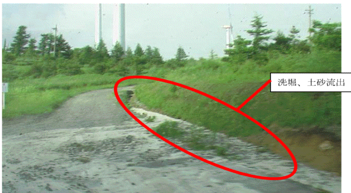
図2-5 道路脇が洗掘されて土砂が流出していた例 9)
