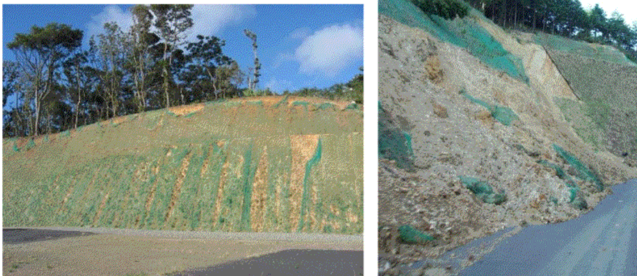
図2-4 法面緑化を図るが定着に至っていない例 9)
