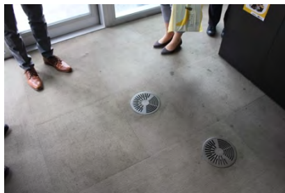
床面からの冷房装置
