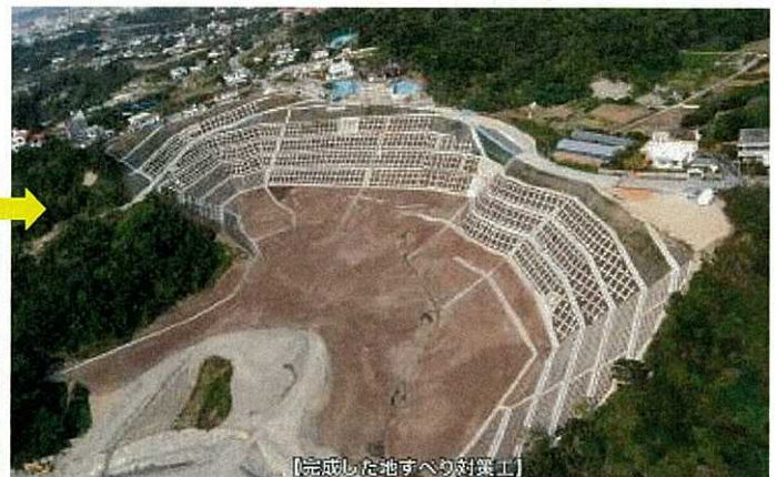
地すべり防止施設の整備状況(平成20年3月)
