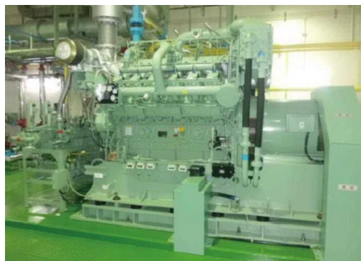
消化ガス発電機（那覇浄化センター）
