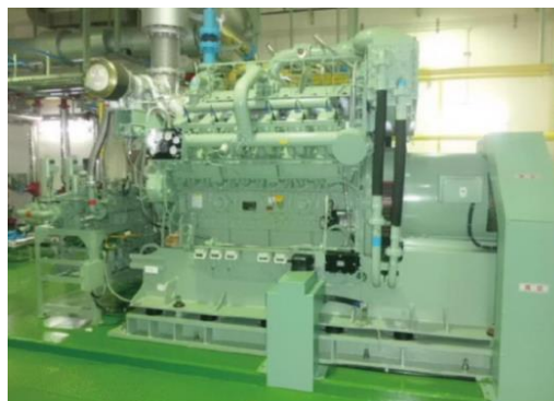
消化ガス発電機（那覇浄化センター）
