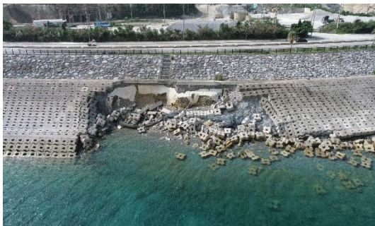
国道449号① 被災状況
