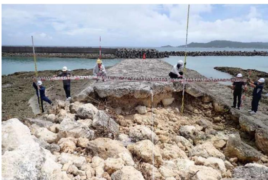
令和5年災 中城湾港(西原与那原地区)
