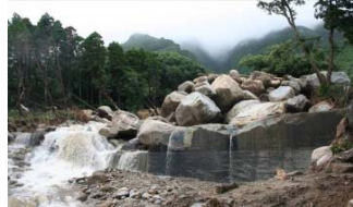
治山堰堤の被災
