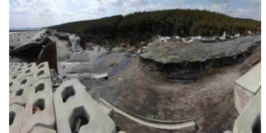
防潮堤及び海岸防災林の被災
