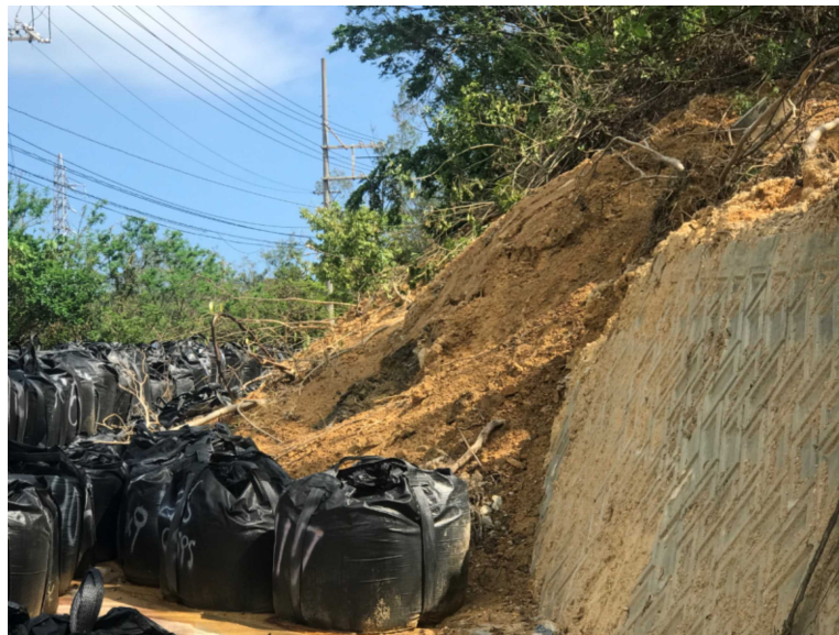
【名護宜野座線 土砂崩れ現場】
