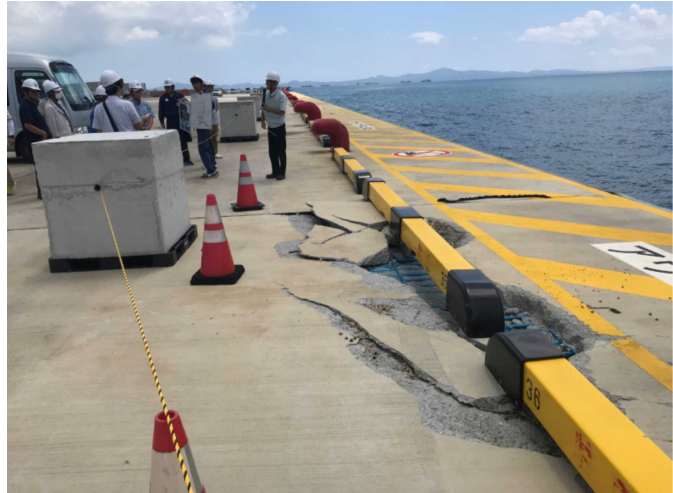
【岸壁張り出し部分が損壊】
