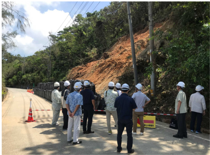
【国道505号崩落現場】
