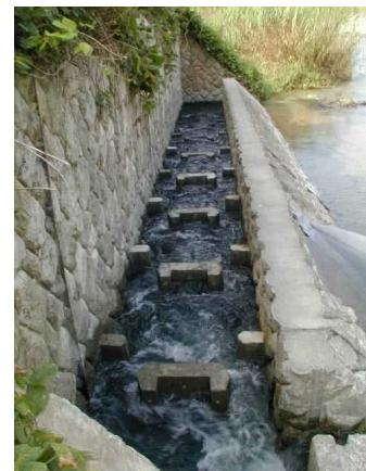
取水施設に設置した魚道
