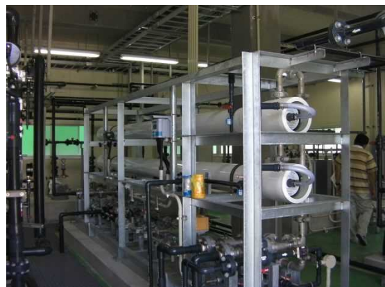
離島海水淡水化施設（座間味村）
