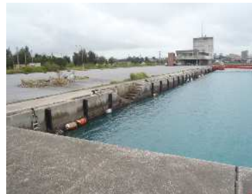
地震に対して脆弱な岸壁
