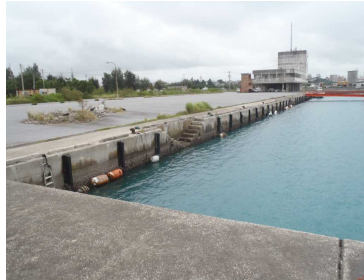
地震に対して脆弱な岸壁
