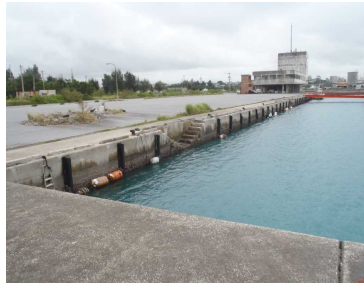
地震に対して脆弱な岸壁
