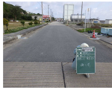
老朽化した舗装(臨港道路)
