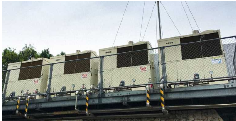
図 4-3 ローザールホテル&スパタワー那覇におけるガスエンジン・コージェネレーション
