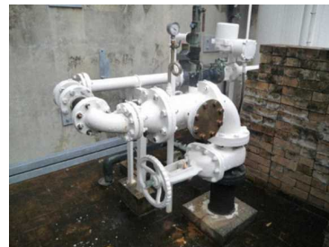
ロワジュールホテル那覇敷地内の温泉井戸
