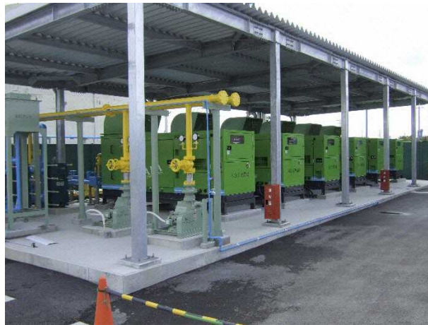
図 4-4 具志川浄化センターに導入したバイオマス発電設備
