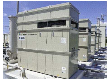
（株）青い海の構内に設置した バイオガスコジェネ
