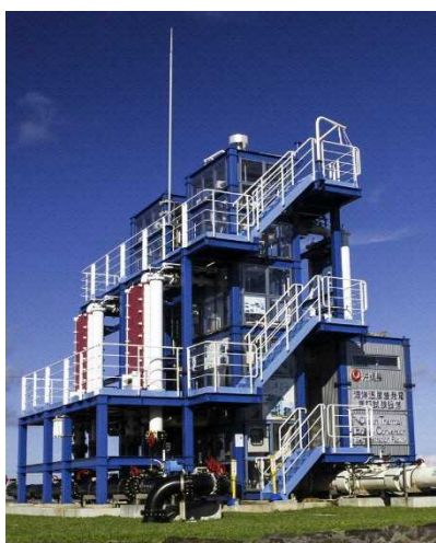
図 4-2 久米島に設置した海洋温度差発電（OTEC）実証試験設備
