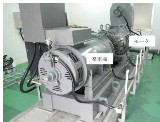
図 4-1 波照間島に設置したモーター発電機（MG セット）
