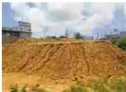
⑤ 裸地法面に発生したリル侵食
