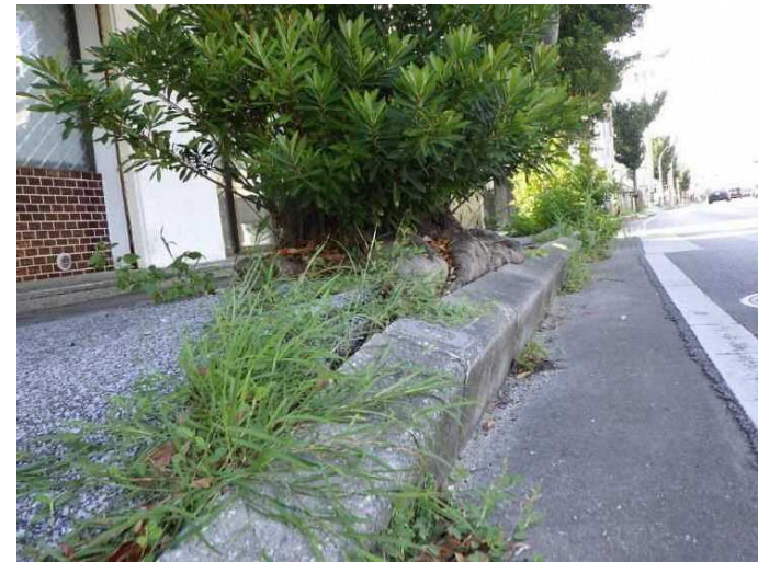
高木の根上りによる縁石のずれ、間隙からの雑草
