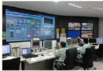
中央監視室(石川)
