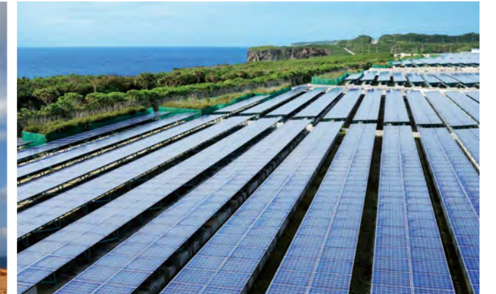
利用自然能源的太阳光发电设备
