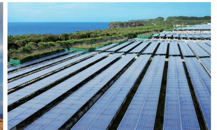
자연 에너지를 이용한 태양광 발전 설비
