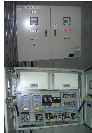
水車発電機制御盤 (エネルギー回収システム盤)
