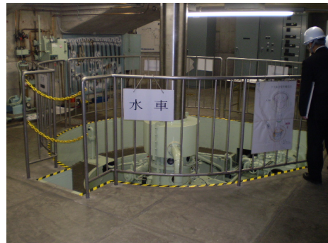
水車(立軸フランシス型, 下久保発電所)
