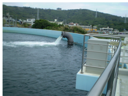
放水口(西原原水調整池)
