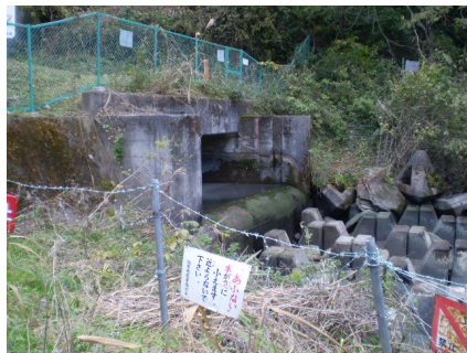
放流口(下久保発電所)
