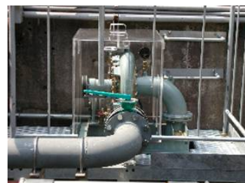
水車発電機 (フランシス水車+オルタネータ)
