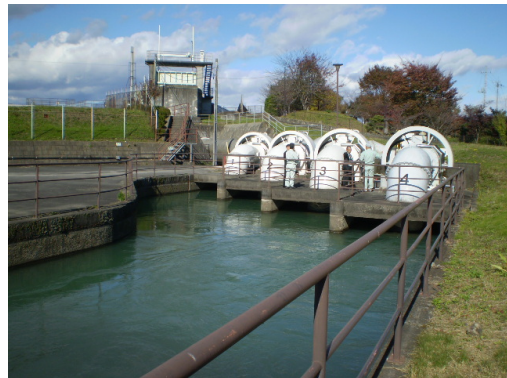
水車発電機全景
