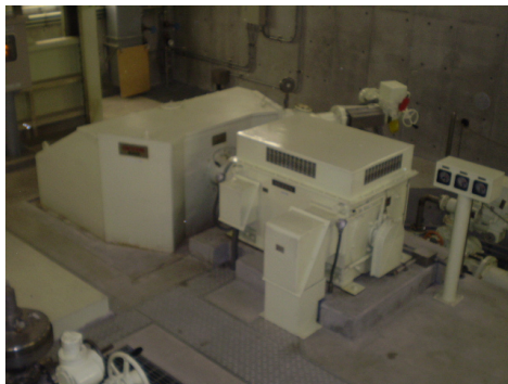
水車発電機(下久保第二発電所)
