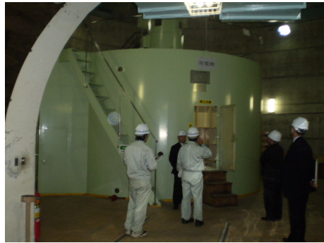
発電機(下久保発電所)
