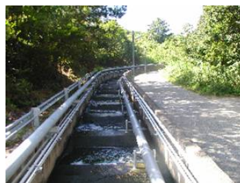
水圧管(右側の管) (排水路の中に設置)
