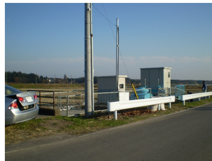
百村第一発電所全景
