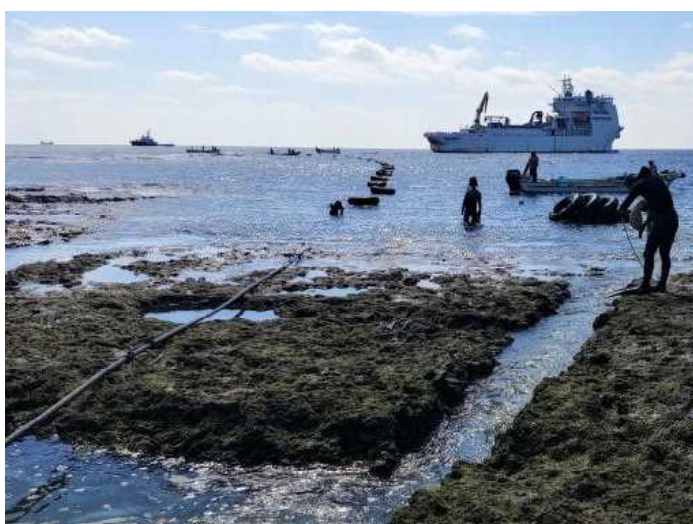
海底光ケーブルの整備状況（沖縄本島と北大東島間）
