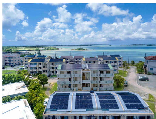
宮古島市市営住宅への太陽光発電設備の導入
