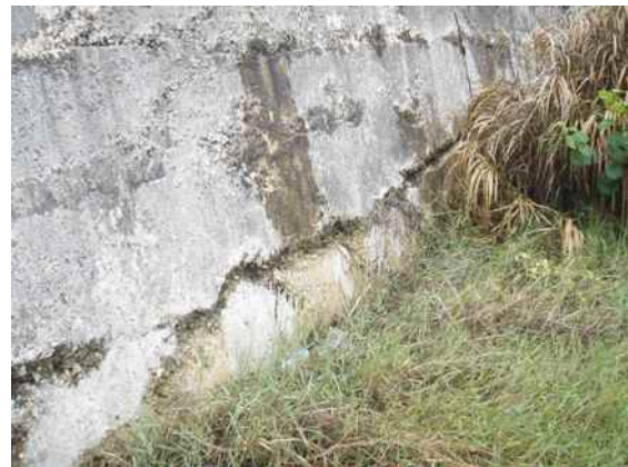
コンクリートの剥離・剥落事例
