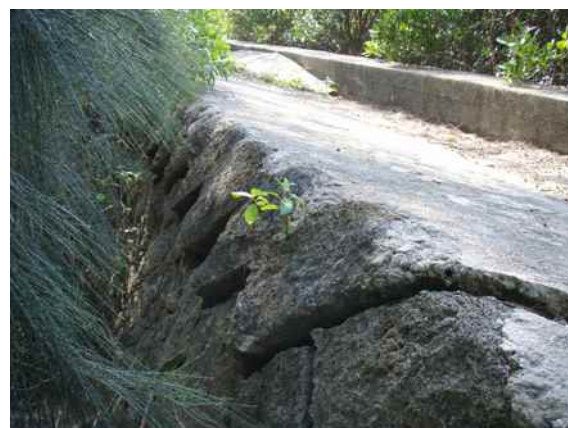
写真 6.2.4 裏法被覆工の石材のずれ (中城湾海岸佐敷地区)
