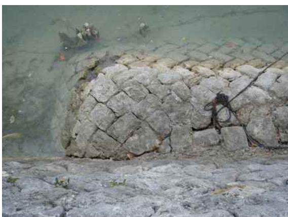
写真 6.2.6 根固工の石材の抜け (桃原漁港海岸)
