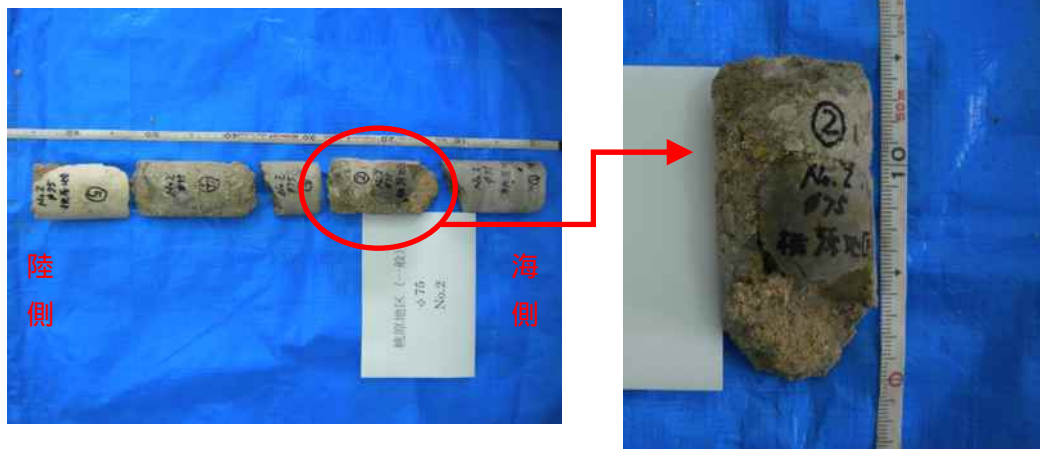
桃原漁港海岸における表法被覆工の状況
