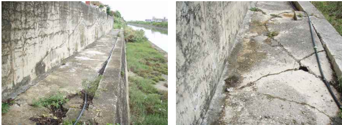
天端被覆工の変状事例(沈下・陥没)
