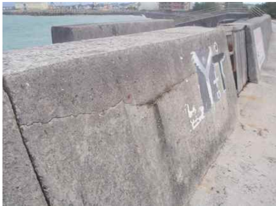
ひび割れ事例
