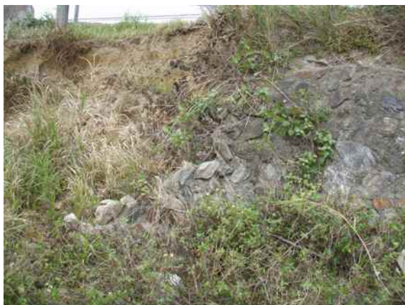
写真 6.2.1 表法被覆工の石材の抜け (東海岸伊是名地区)
