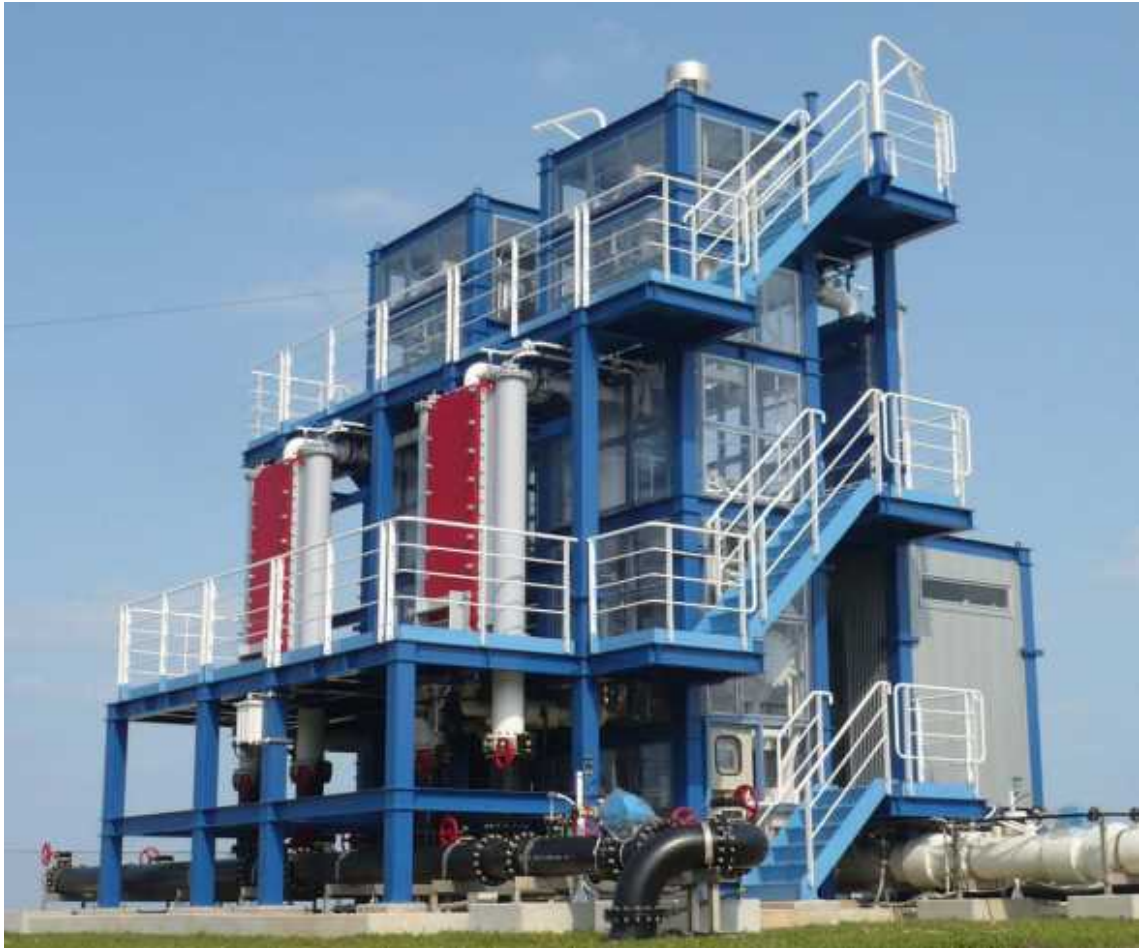
図 5-5-1 海洋温度差発電実証設備（久米島）
