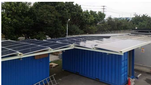
太陽光パネル (コンテナPV流用)
