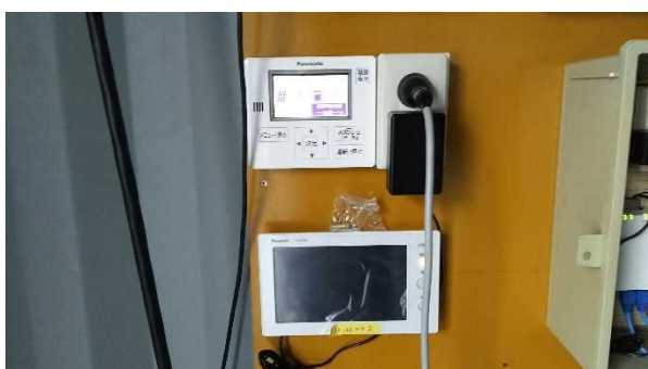
蓄電池装置リモコン
