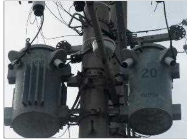
写真㉓ 柱上トランス 2
