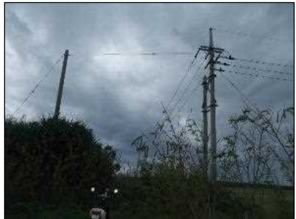
写真② 高圧線ルート 1
