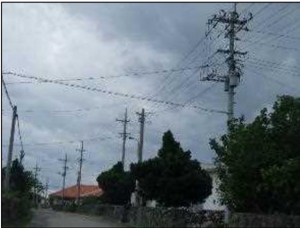
写真㊱ 柱上トランス 1
