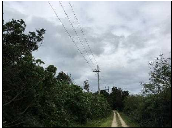
写真④ 高圧線ルート 2
