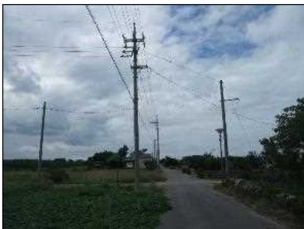
写真㊟ 高圧線ルート5
