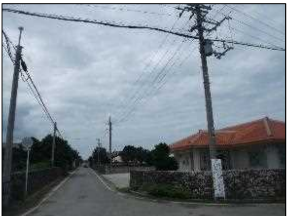
写真㊳ 高圧線分岐 1
