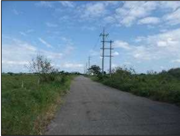
写真⑳ 高圧線ルート 13
