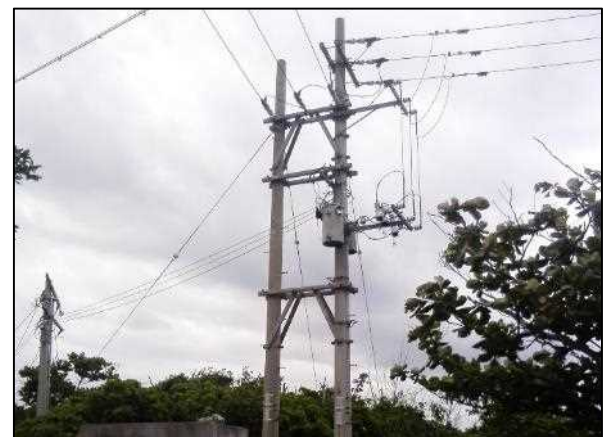
写真⑥ 柱上トランス
