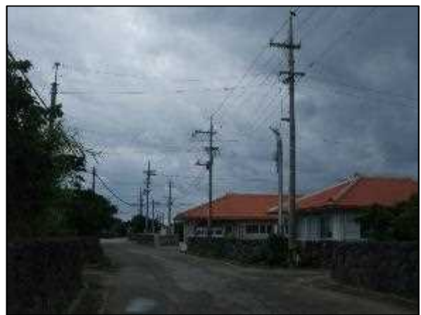
写真㊲ 柱上トランス 2
