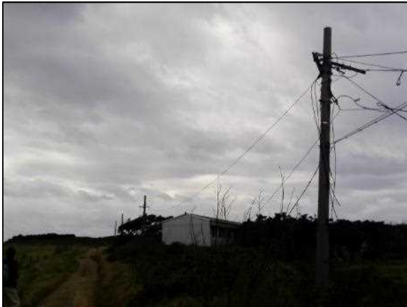
写真⑦ 低圧線ルート
