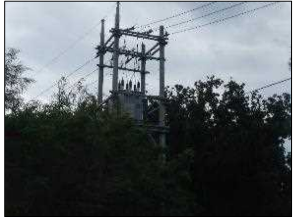
写真㉟ 柱上昇圧調整器（拡大）
