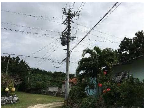
写真⑪ 柱上トランス 2
