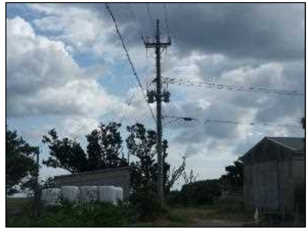
写真⑧ 柱上トランス1
