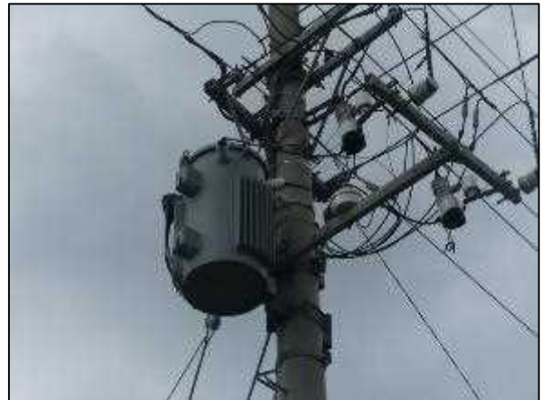
写真㊧ 柱上トランス 3
