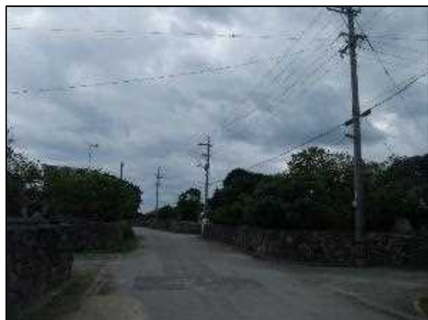
写真㊫ 高圧線ルート 4
