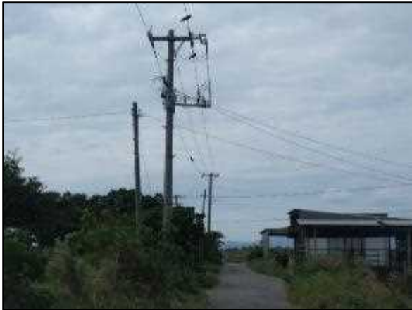
写真⑱ 高圧線ルート 9
