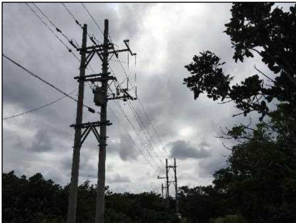
写真⑤ 柱上トランス 1
