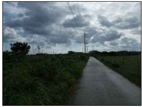
写真④ 高圧線ルート 2
