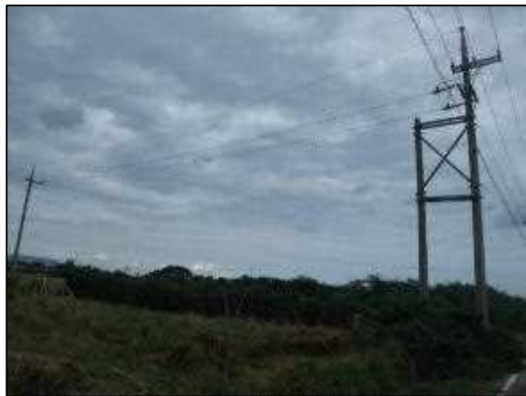
写真⑪ 高圧線分岐1
