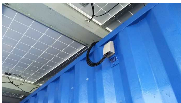
配線引込み部分
