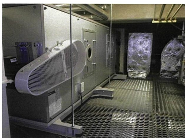
蛹室上部機械室空調機取替後
