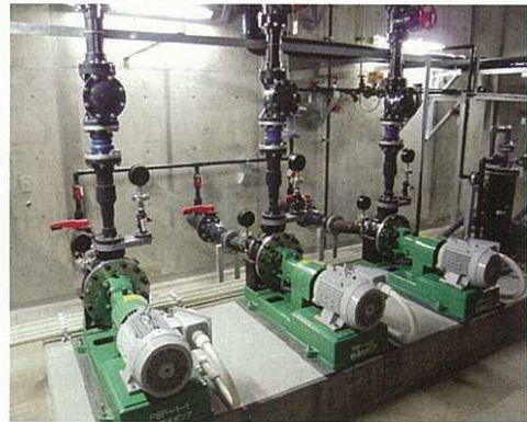
取水貯水棟(地下1階ポンプ機械室)
