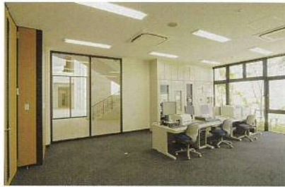
中央監視制御盤により一元管理
