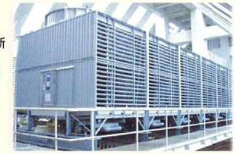
冷却塔の更新
