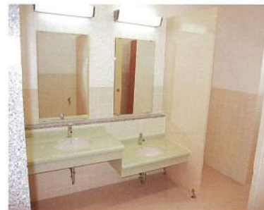
トイレ手洗い
