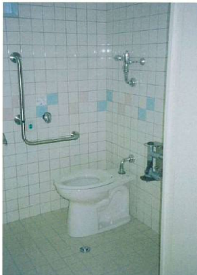
障害者用便所
