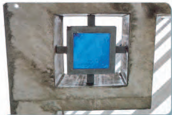
デッキの底の部にアクセントとして板ガラスが埋め込まれている。 （パレット久茂地、那覇市）
