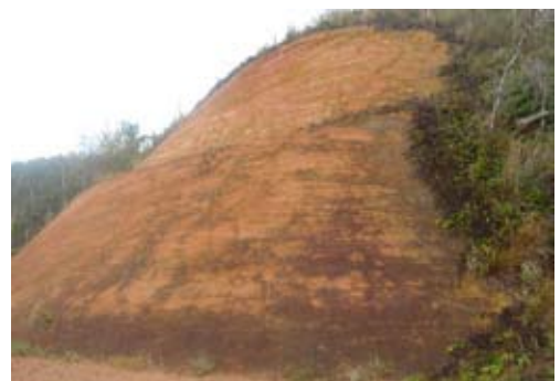
裸地化したのり面
