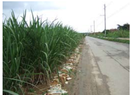
道路際まで耕作し土砂が流出している例
