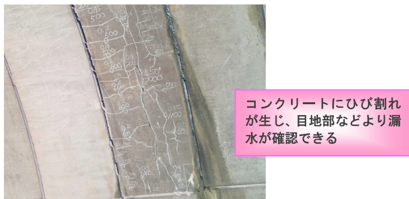
写真-1 早急な補修が必要となる例
