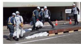
軽量段差修正材による橋梁段差補修 （首都高速道路株式会社）
