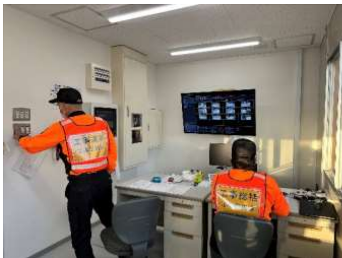
木材倉庫 照明点灯
