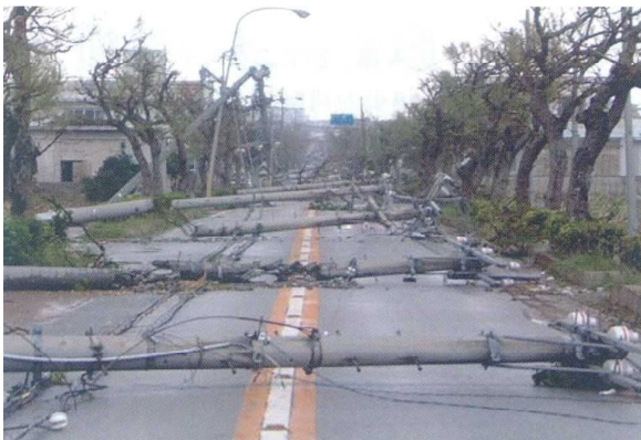
平良城辺線(宮古島市城辺) 平成 15 年台風 14 号で倒壊した電柱
