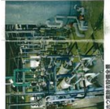
海水淡水化設備
