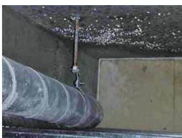
内部結露の事例 (天井裏のスラブ下面の水滴)
