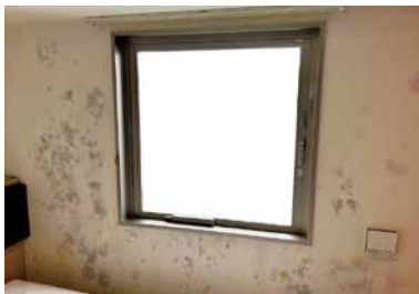
内部結露（窓周囲の壁紙裏側のカビ）
