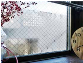
ガラス窓外側につく曇り
