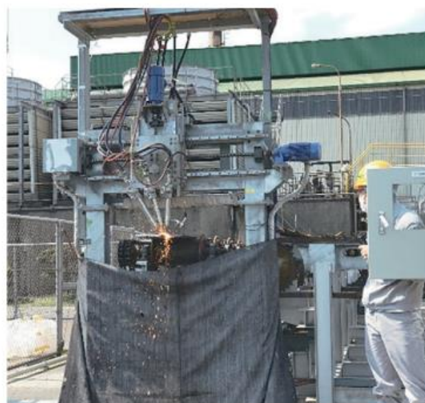
図7 完成した自動切断装置
