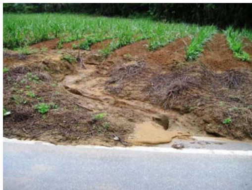
写真1-10 さとうきび畑の侵食状況 (西表島)
