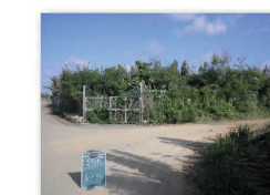
農業水利施設保全合理化事業による改修前のフェンス
