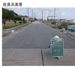
傷んだ舗装(臨港道路)
