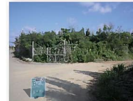
農業水利施設保全合理化事業による改修前のフェンス
