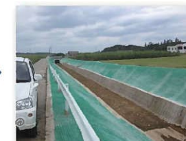
水利用調整・高効率化支援事業による改修前の法面保護
