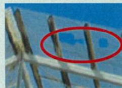
屋根材の劣化
