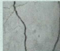
コンクリート壁のクラック
