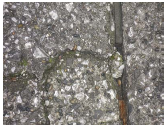
床のひび割れにも食中毒菌や昆虫がひそんでいることがあります。
