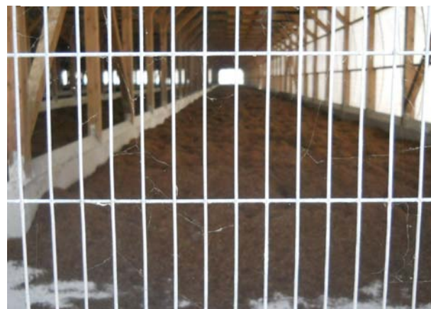
（幅の狭い金網で野鳥の侵入を防止している例）
